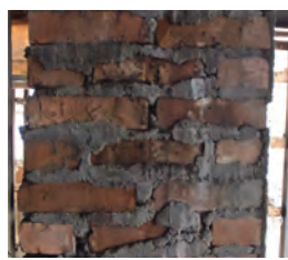
煙突裏側 壁板とのあたり
