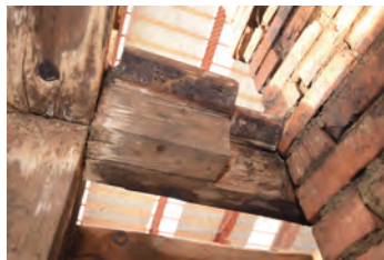
切欠かれた床梁
