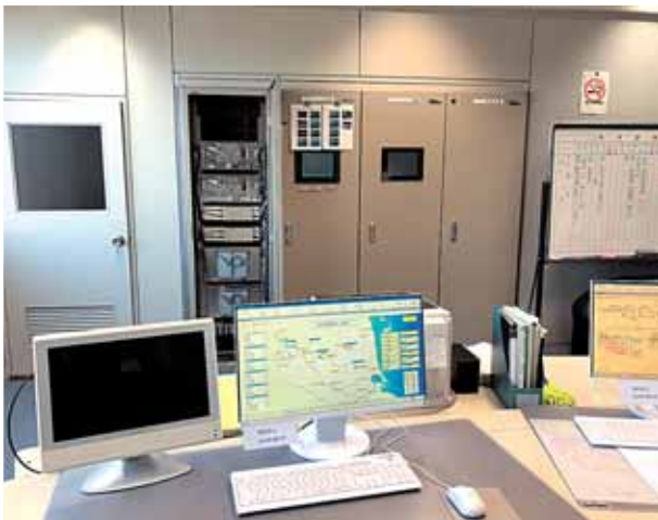
無線装置を利用し水道施設を集中管理している
