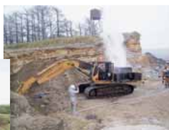
◀作業中のパワーショベルから出火
