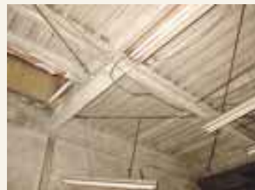
耐火被覆で吹付けたアスベスト(鉄骨)
