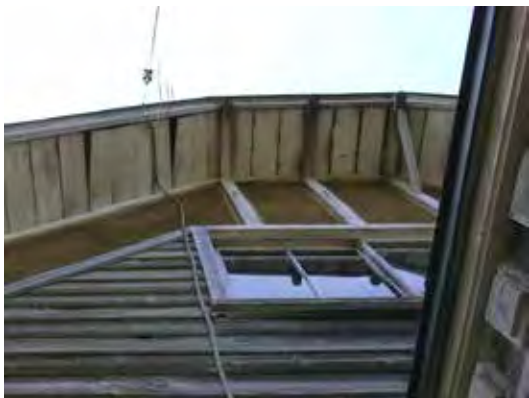
写真 25 軒天板および方杖の欠損
