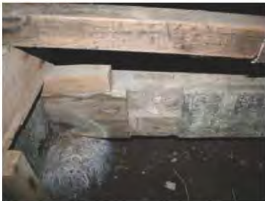
写真 1 茶の間 腰掛け蟻の痕跡
