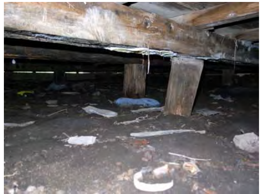
写真 14 仏間 床下の状況
