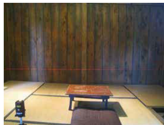
写真 20 客室 6 床の不陸（赤線はレーザー=水平）
