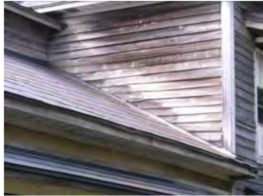
写真 24 下見板の腐朽
