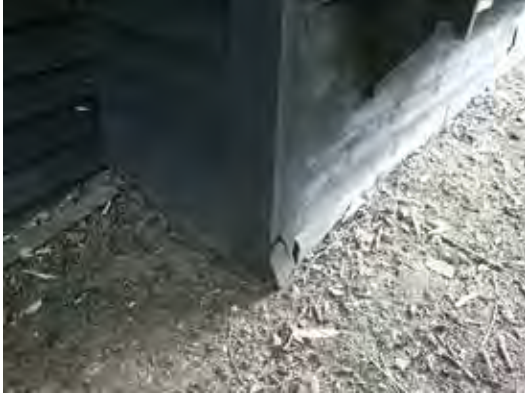
写真 39 基礎部の埋没
