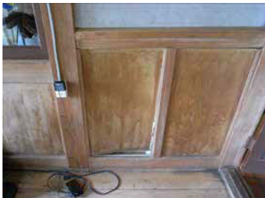
写真 19 事務所 腰板壁の破損
