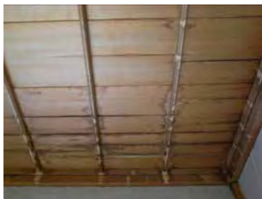
写真 10 茶の間天井 雨漏り
