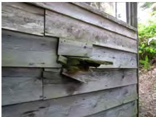
写真 31 排水口の破損
