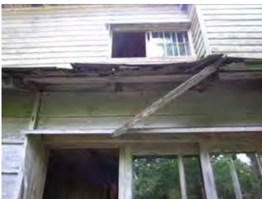
写真 45 広小舞の腐朽
