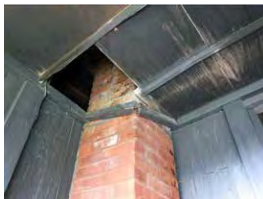
写真 18 裏玄関 廻縁の脱落・天井板の欠損
