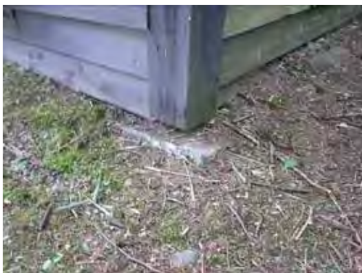
写真 15 柱と礎石との浮き
