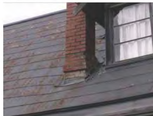
写真6 屋根面の垂下
