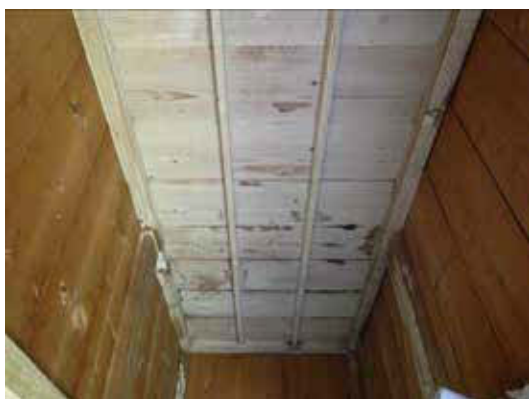
写真 17 客室 8 縁側天井 雨漏り
