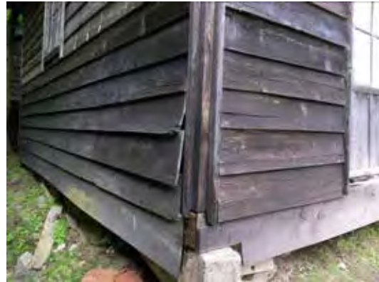
写真 42 下見板の捲れ
