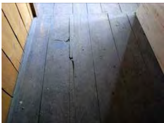
写真 21 小屋裏 床板の割損
