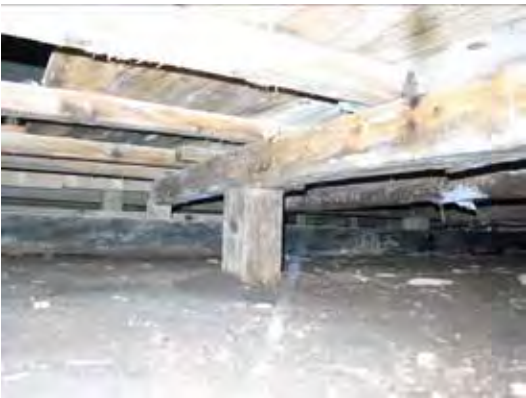
写真 13 仏間 床下の状況
