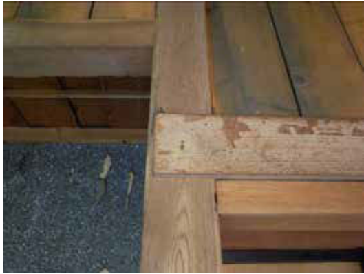
写真 23 客室 7 釘隠（船形）の欠損
