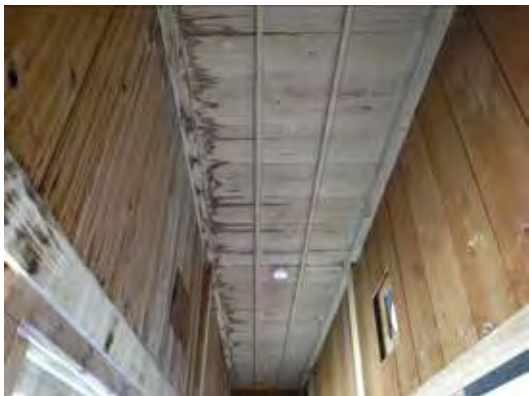
写真 15 客室 5 縁側天井 雨漏り
