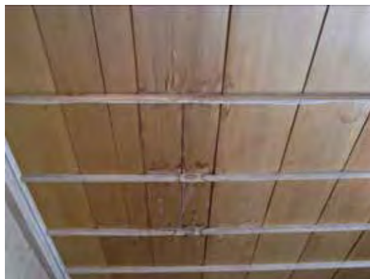
写真 12 仏間天井 雨漏り
