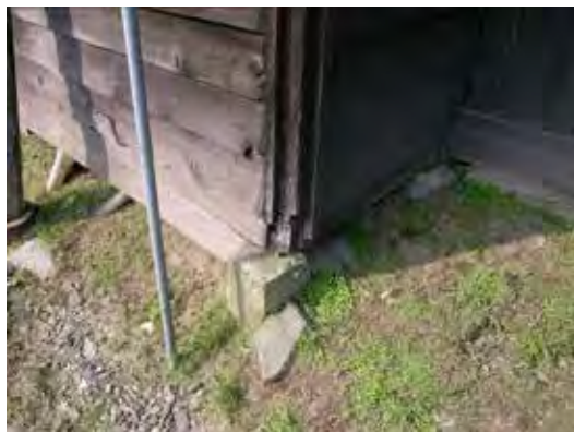
写真 18 コンクリート製独立基礎のズレ
