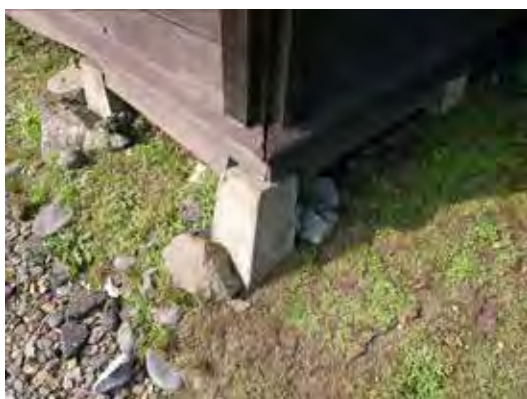
写真 19 コンクリート製独立基礎の傾斜
