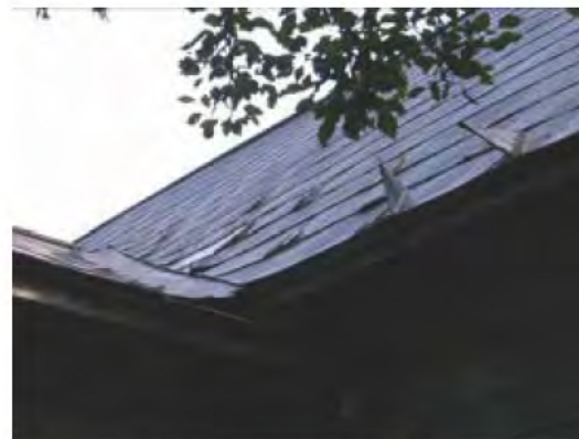
写真4 垂鉛鉄板の捲れ
