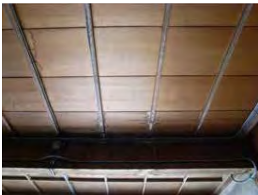
写真 7 玄関天井 雨漏り
