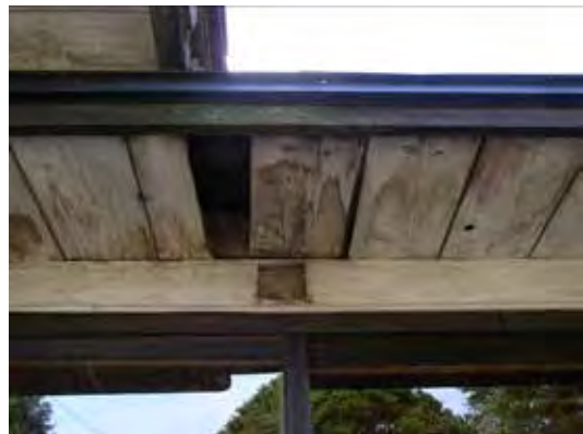
写真 28 軒天板の欠損
