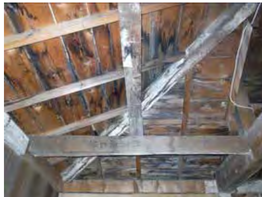
写真 16 物置野地 雨漏り
