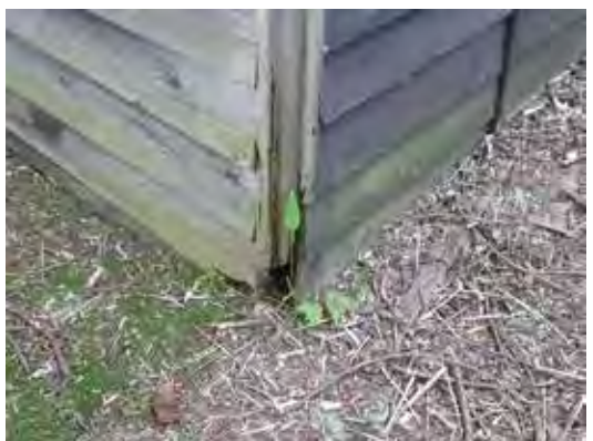
写真 16 柱脚と土台の腐朽
