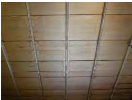
写真 11 茶の間天井 雨漏り
