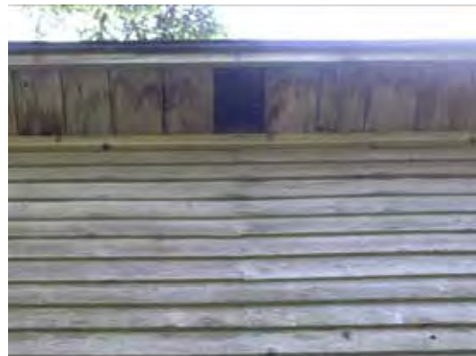
写真 44 軒天板の欠損
