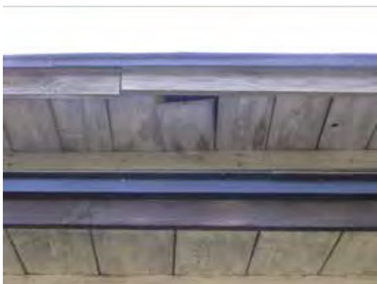
写真 29 軒天板のズレ
