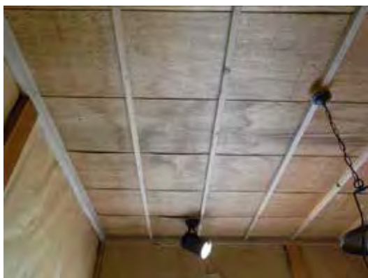
写真 13 客室 2 天井 雨漏り
