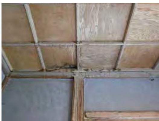
写真 9 事務所天井 雨漏り
