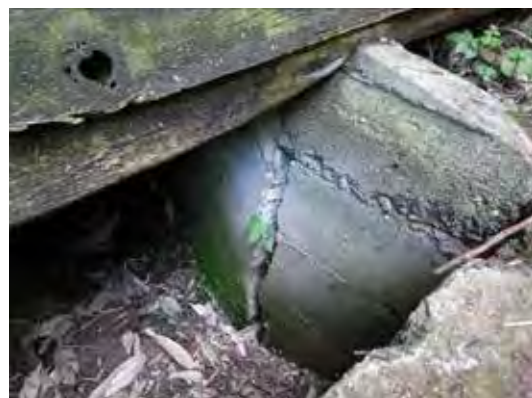
写真 46 コンクリート槽の割れ
