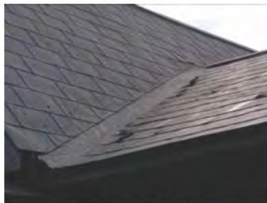
写真2 垂鉛鉄板の捲れ
