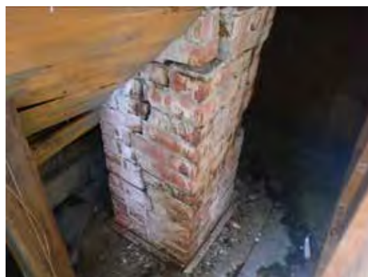
写真 22 小屋裏 煙突の割裂
