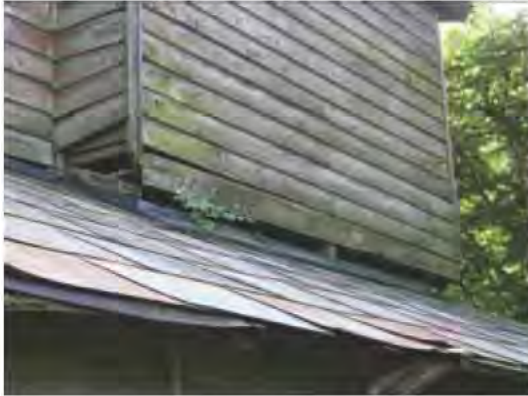
写真 47 下見板の脱落
