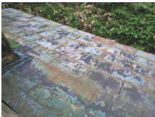
写真1 全体的に経年劣化が見られる屋根面
