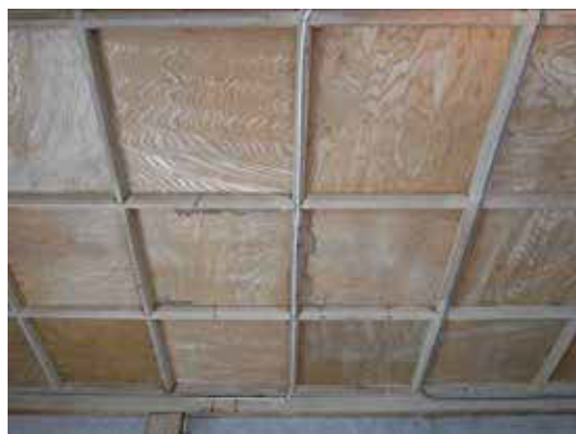
写真 8 事務所天井 雨漏り
