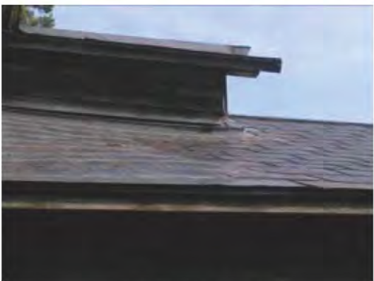
写真3 屋根面の垂下
