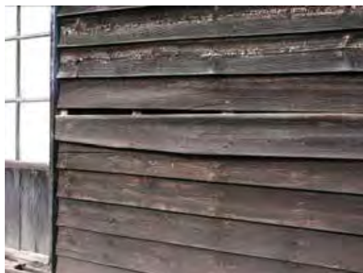
写真 36 下見板の脱落
