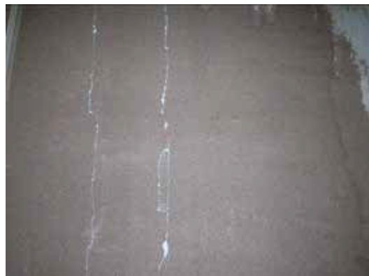
写真 20 仏間トコ 壁の割裂
