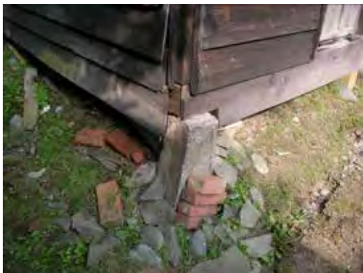
写真 17 コンクリート製独立基礎のズレ
