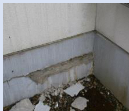
基礎モルタルの剥離
