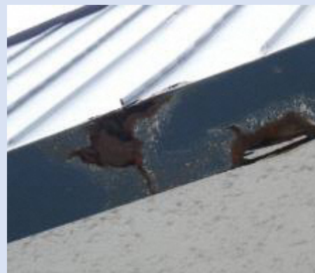
屋根板金の劣化(旧校舎棟)
