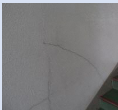
階段室内壁のヒビ割れ
