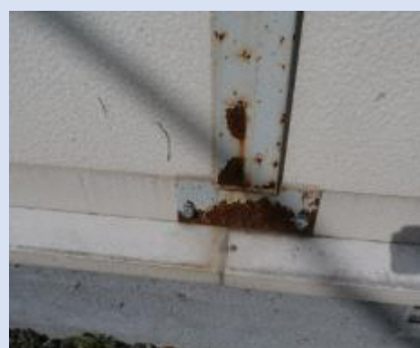
外壁鉄骨サビ(増築プレハブ棟)
