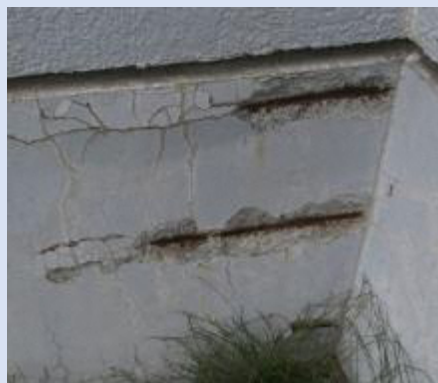
基礎配筋のサビ・膨張
