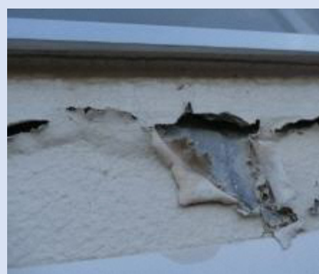
外壁塗装剥離
