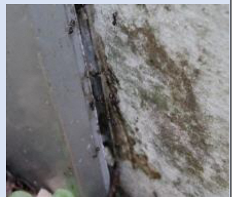
エキスパンジョイント部のシール劣化
