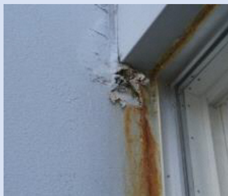
外壁塗装亀裂・剥離
