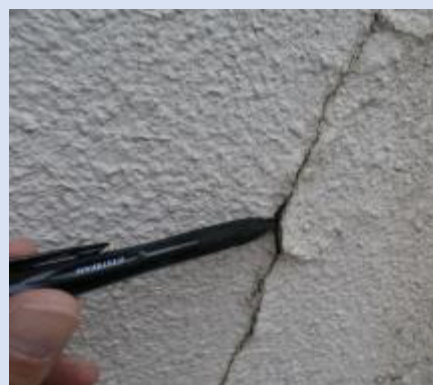
外壁塗装亀裂
