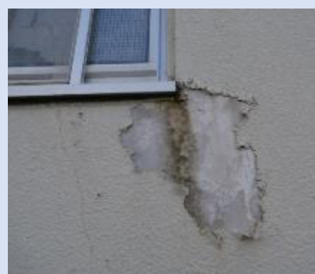
外壁塗装剥離
