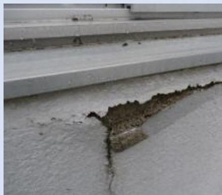
サッシ下部充填モルタル剥離
