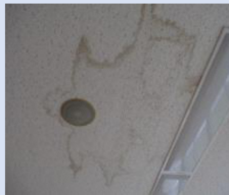
天井の雨漏り跡
