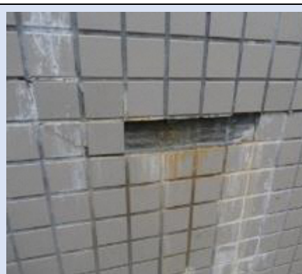
外装タイル部分亀裂・剥離
