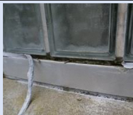
ガラスブロックシーล剥離
