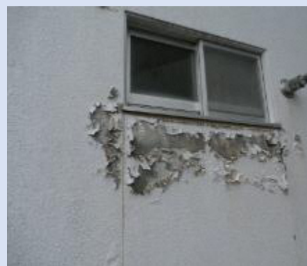
外壁塗装剥離
