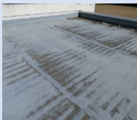
屋上防水(トップコート劣化)
