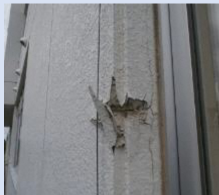
サッシ周辺の劣化
