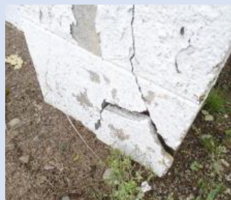
基礎モルタル亀裂・剥離
