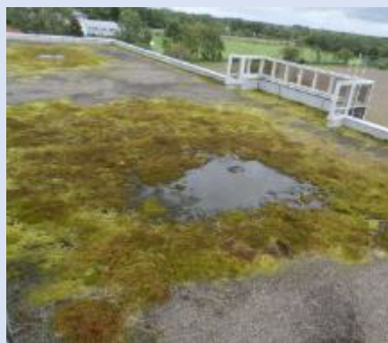
屋上防水(劣化)
