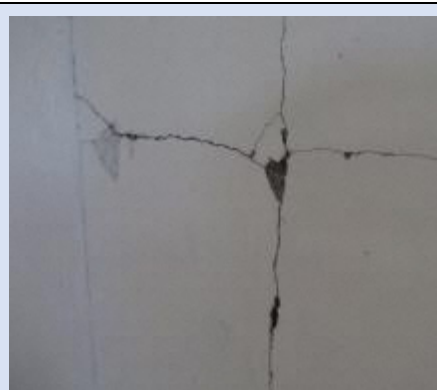
体育館内壁の亀裂
