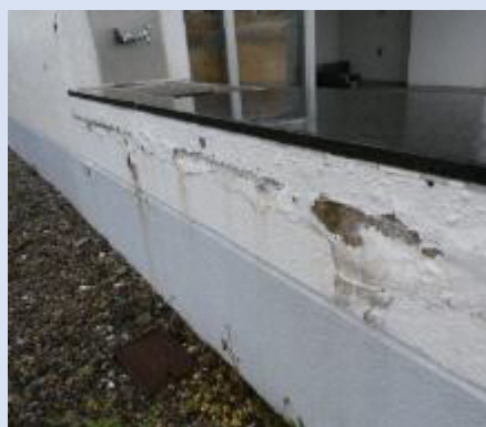
外壁塗装剥離
