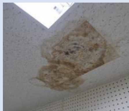
天井雨漏り跡(放送室)
