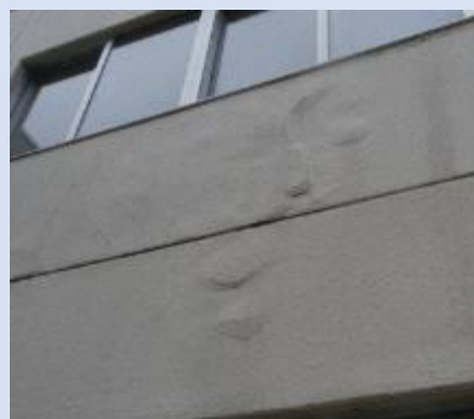
外壁(塗装浮き)
