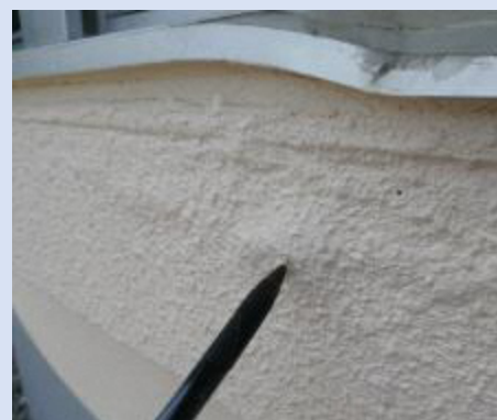
外壁塗装の浮き
