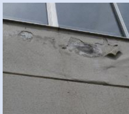
外壁塗装浮き(剥離)
