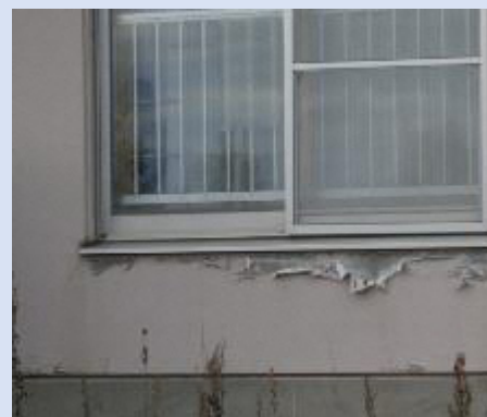
外壁塗装剥離
