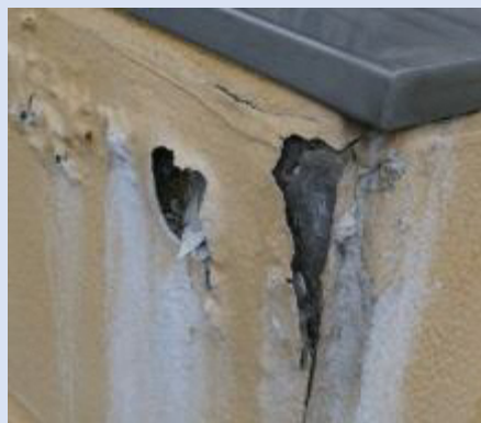
塗装劣化(剥離)
