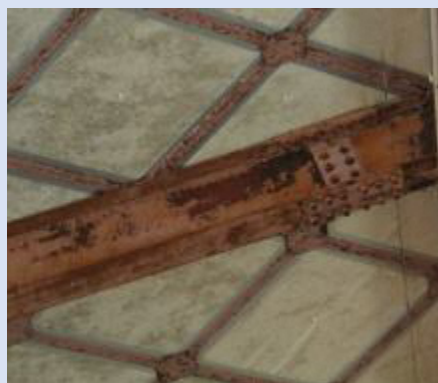
結露による鉄骨錆び
