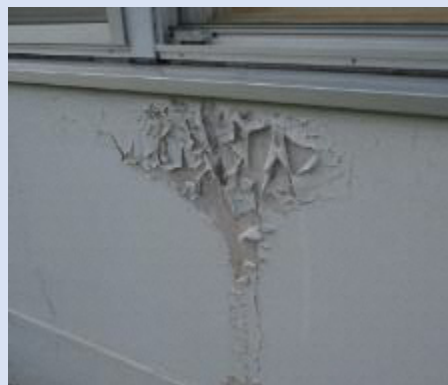
塗装劣化(剥離)
