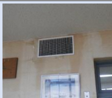
内装劣化・汚れ(校長室)
