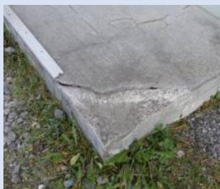
玄関ポーチ破損
