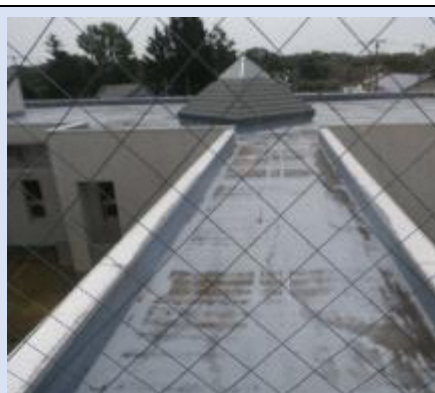
屋上防水(トップコート劣化)
