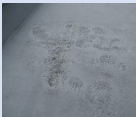
屋上防水(トップコート劣化)
