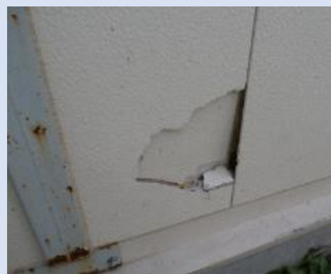
外壁破損(増築プレハブ棟)
