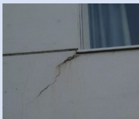
サッシ周辺の外壁亀裂
