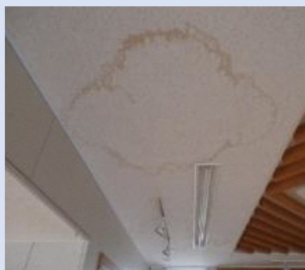
天井雨漏り部
