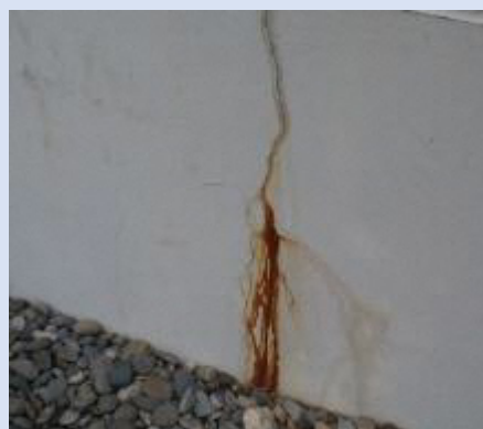
基礎モルタル亀裂(内部配筋サビ)
