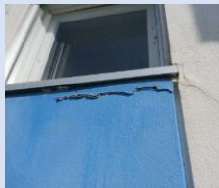
サッシ周り充填モルタル剥離
