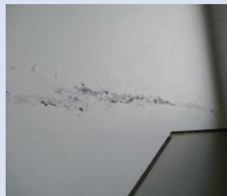
共用階段部の亀裂・塗装剥離
