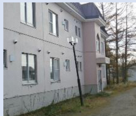
屋外照明柱の傾斜
