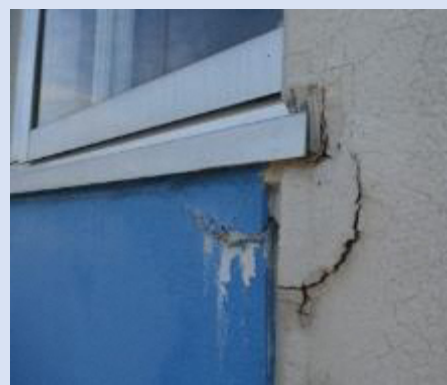
サッシ周り充填モルタル剥離
