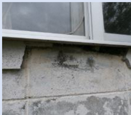
サッシ周辺部の劣化
