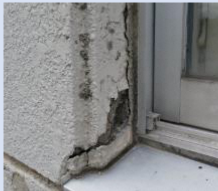
サッシ周辺部の劣化
