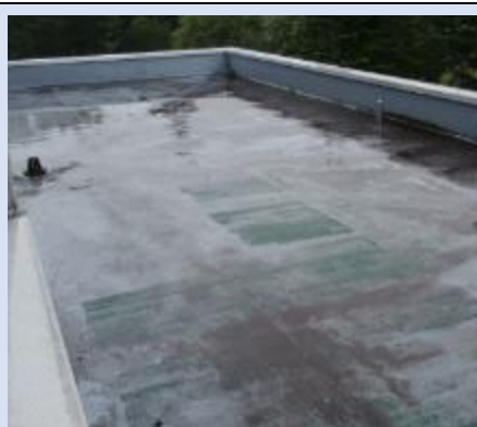
屋上防水(トップコート劣化)
