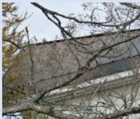
屋根塗装の劣化(変色)
