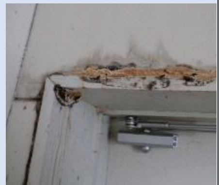
雨漏り跡(カビの繁殖)
