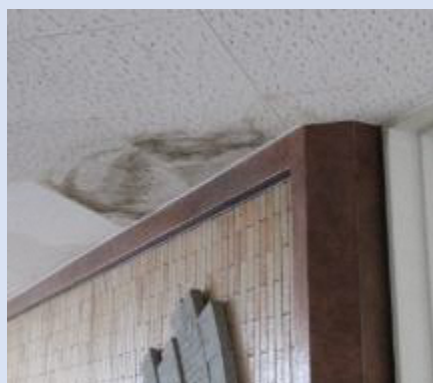
天井雨漏り跡
