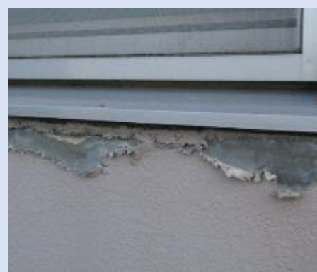
外壁塗装剥離
