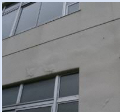
外壁(塗装浮き)
