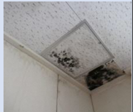
天井雨漏り部
