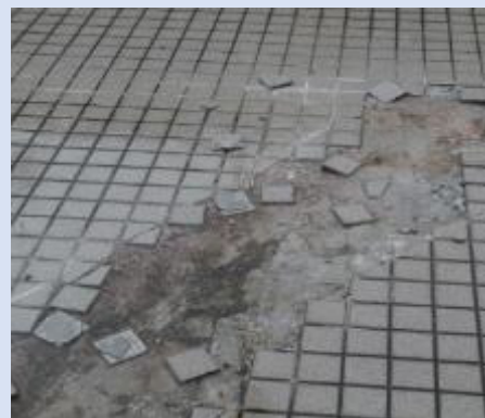
玄関ポーチ床タイル剥離
