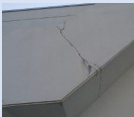
屋外階段破損
