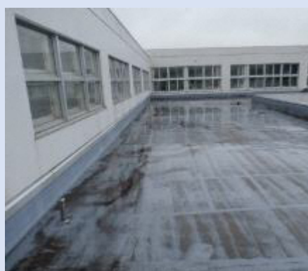
屋上防水(トップコート劣化)
