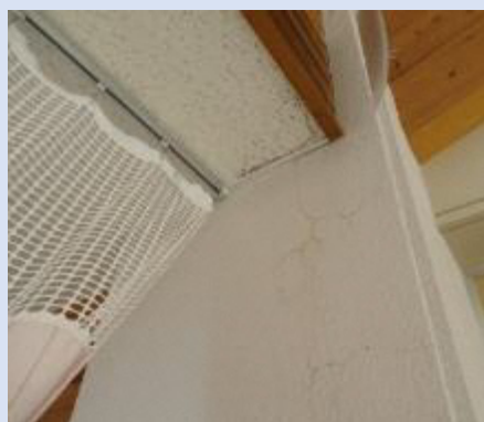
雨漏り箇所①
