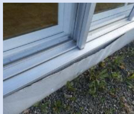
基礎モルタルの剥離(帯状一面)
