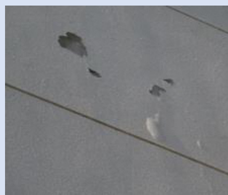
塗装劣化(剥離)
