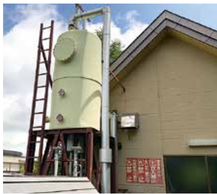
ふるさと交流館の心臓部 源泉ポンプ施設
